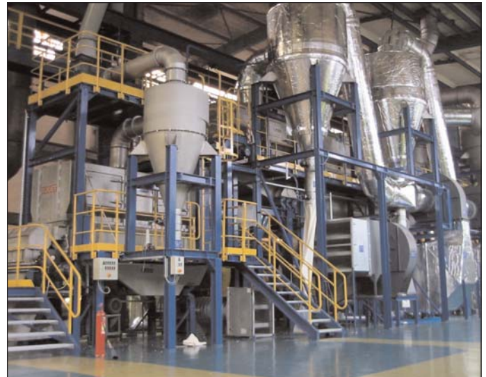
Mit dieser Vibrationsfließbettanlage zur Trocknung und Kühlung von synthetischem Kautschuk hat JÖST in einem neuen Markt Fuß gefasst.
