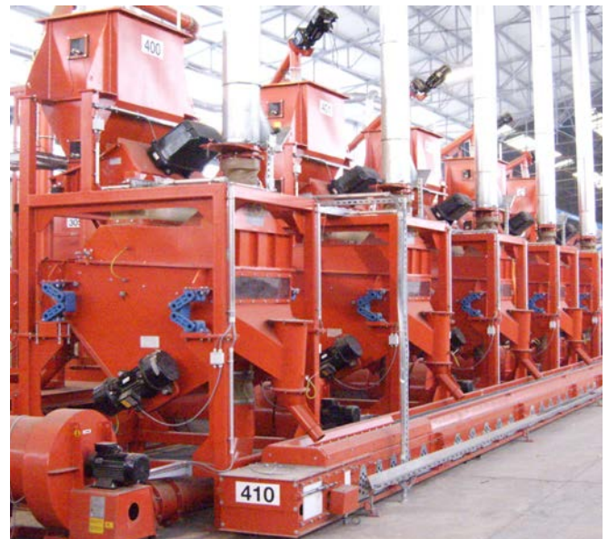
Trenntische mit Dosierstation / Separation Tables with Dosing Station
